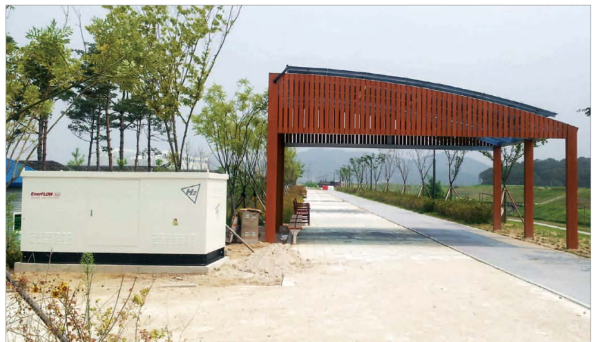
세종시에 설치된 에이치투의 VRFB ESS EnerFLOW320 제품
