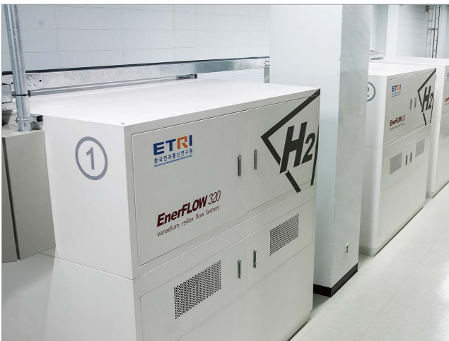
ETRI에 설치된 에이치투의 VRFB ESS EnerFLOW320 제품
